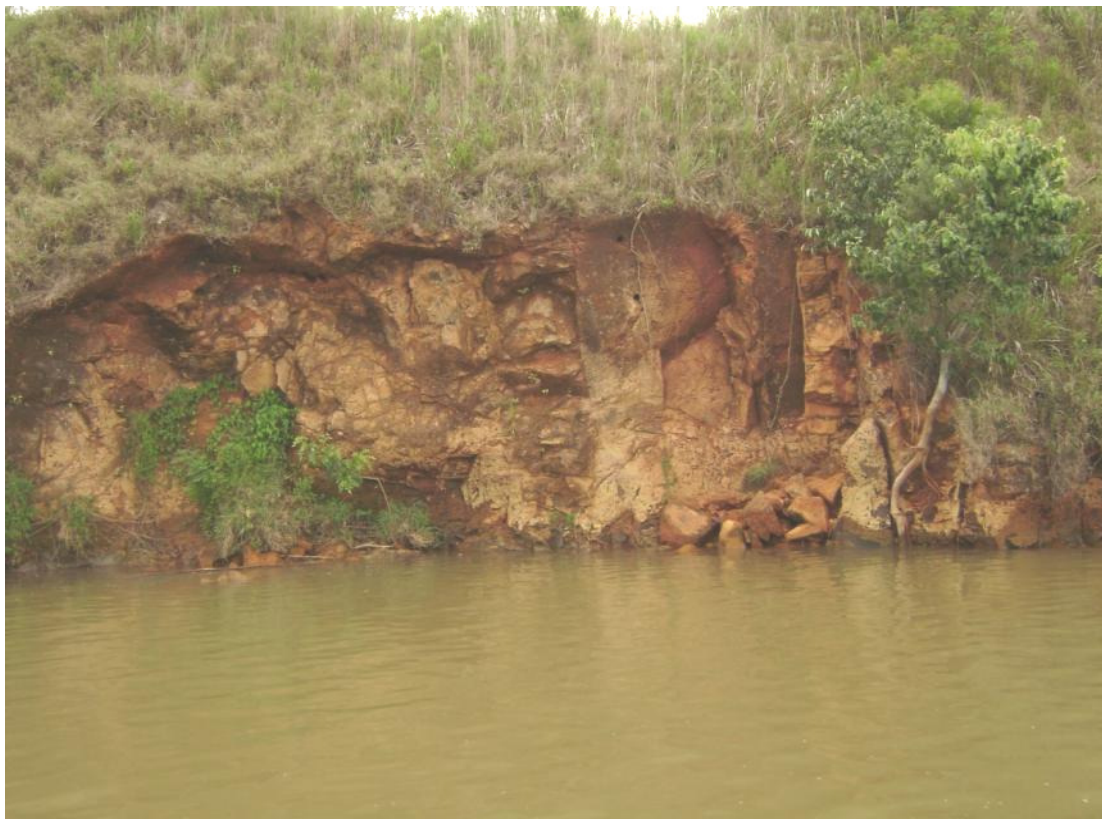
Foto 5-15 Vista geral de um talude de rocha decomposta na margem do reservatório da Barragem de Itá, com ocorrência de um escorregamento
