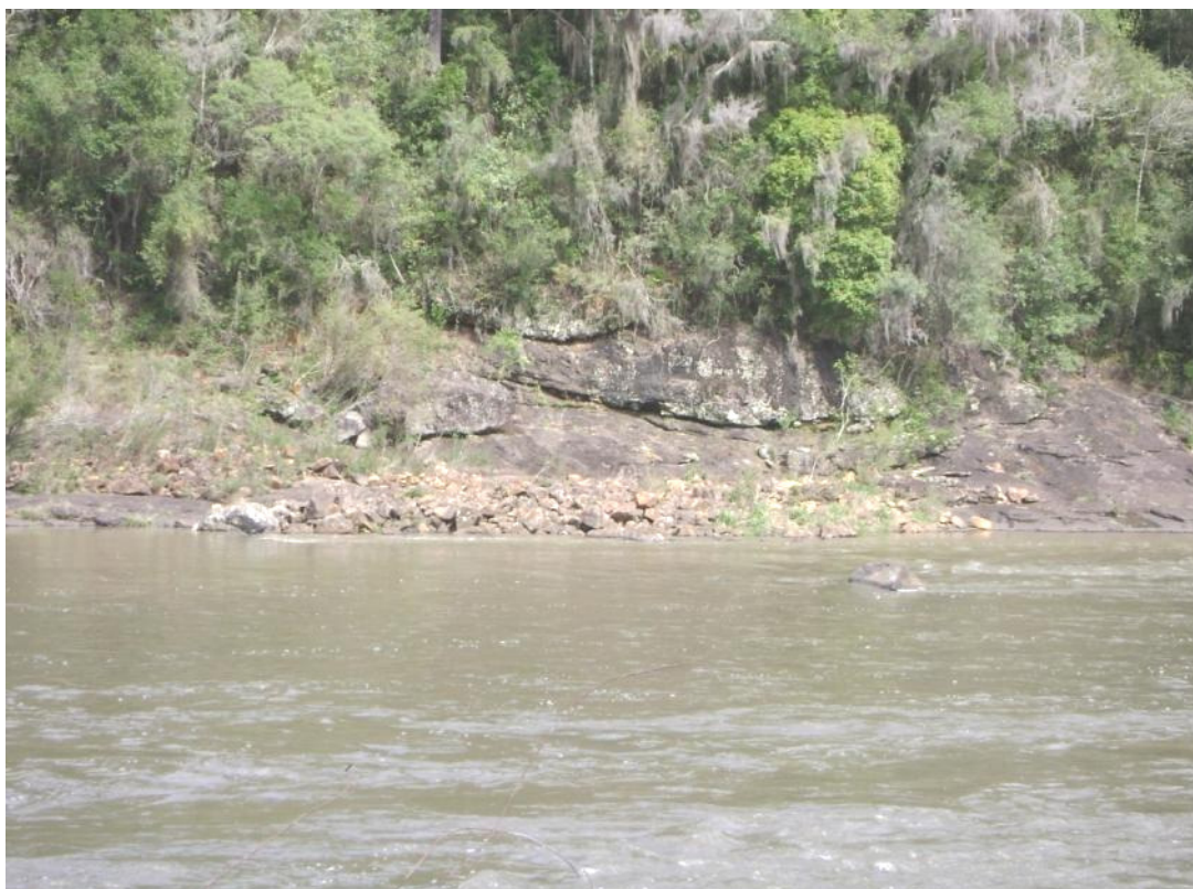
Foto 5-12 Vista de um talude rochoso na margem esquerda do rio Pelotas (trecho em que está previsto o AHE Passo da Cadeia) onde se pode observar uma descontinuidade potencialmente favorável à ocorrência de um deslizamento planar
