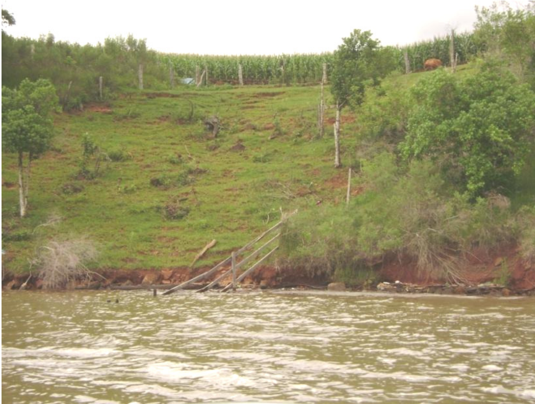
Foto 5-13 Vista geral de um talude coluvionar na margem do reservatório da Barragem de Itá – vê-se na linha d'água erosão do talude, potencializando a instabilidade do mesmo ao escorregamento
